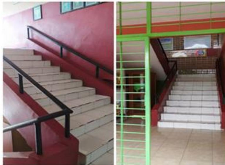
Gambar 1. Tangga Gedung SDN 09 Makasar
